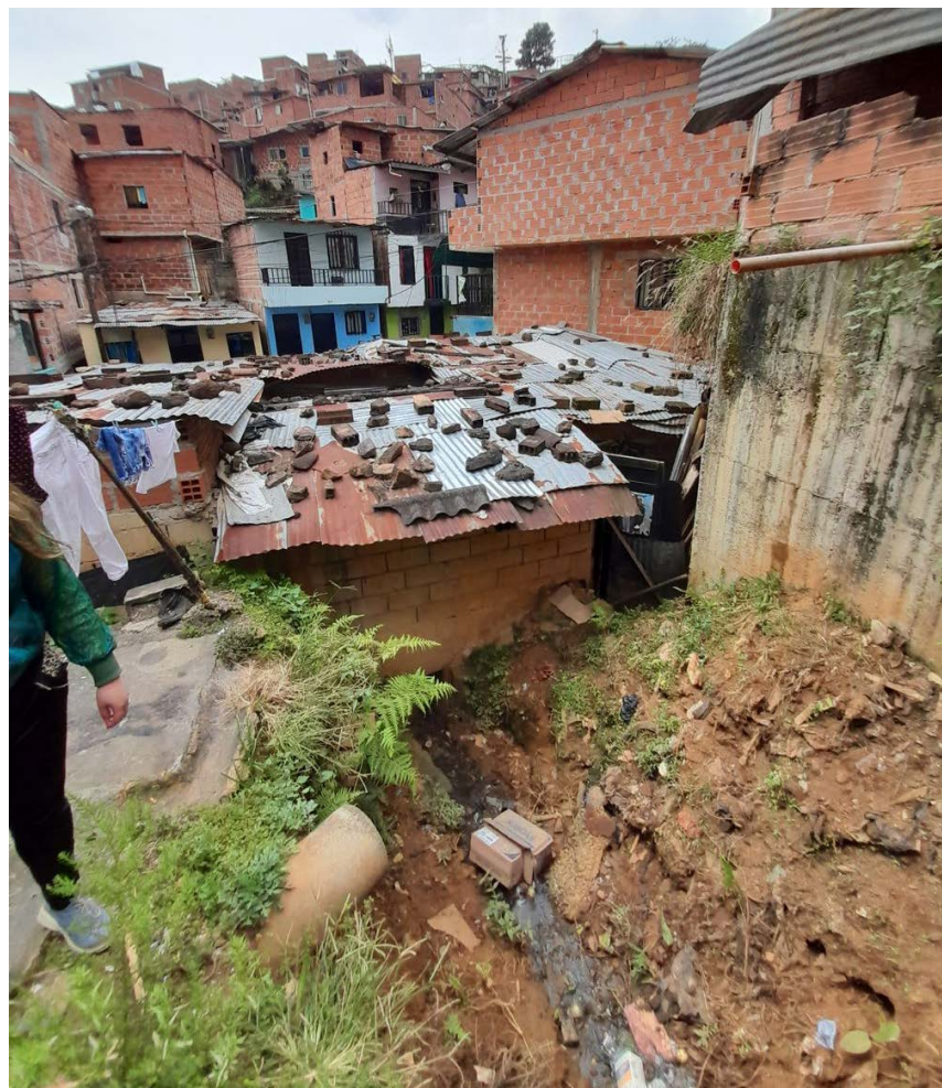
Figura 13. Fuentes naturales de agua utilizadas como alcantarillado para las viviendas
