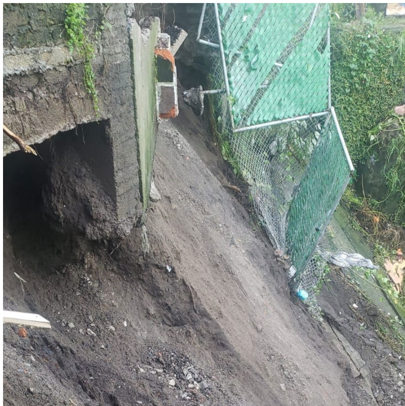
Figura 5. Afectaciones en la vivienda analizada
