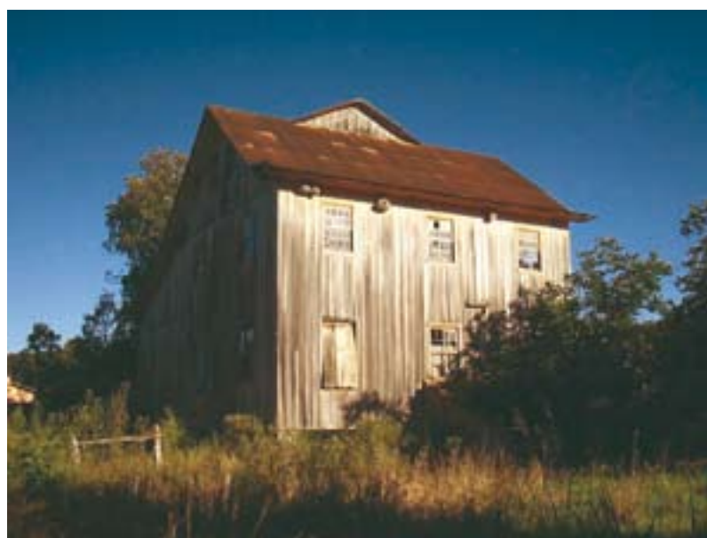
▲ Figura 13 Moinho de Ilópolis, antes da intervenção Fonte: Acervo do escritório Brasil Arquitetura
