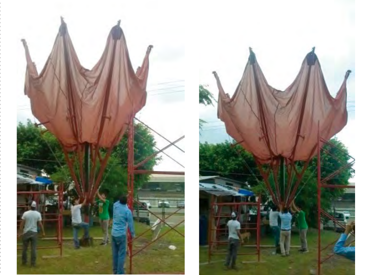
Figuras 73 a 78. Se realizó el primer despliegue del paraguas plegable con membrana; este primer intento falló porque los reguladores estaban semiabiertos y esto impidió que la membrana se tensara completamente Fuente: Morales (2013).
