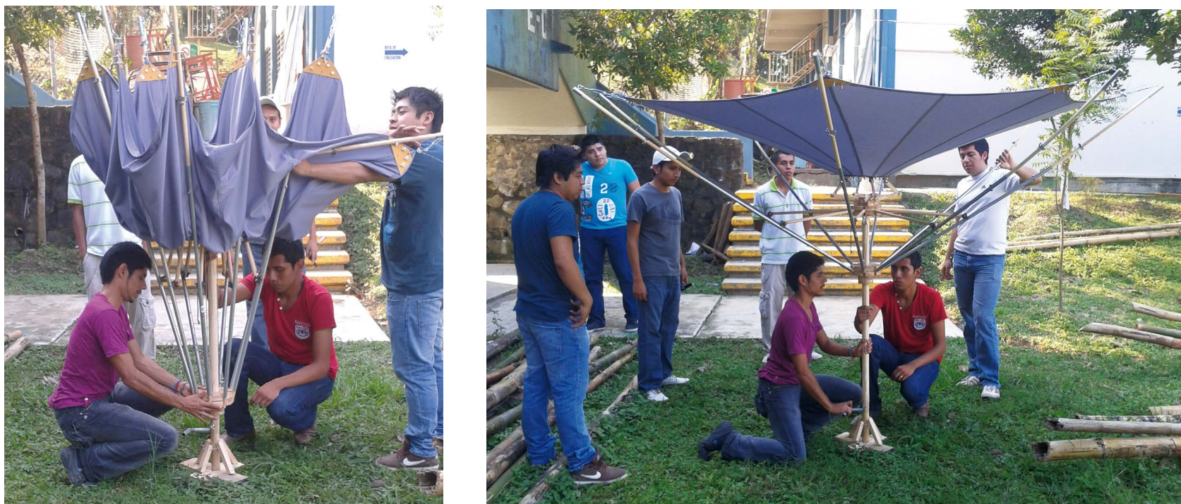
Figura 16. El modelado del paraguas retráctil ayudó a generar detalles constructivos más exactos para su funcionamiento al desplegado Fuente: Morales (2013b).
