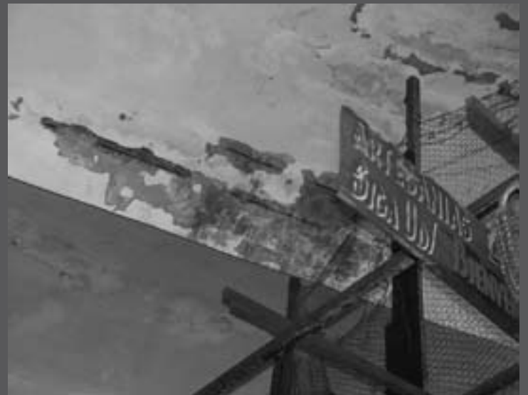
FOTO 11. MERCADO DE GIRARDOT EN 2006: El óxido en las bóvedas, numerosos cables eléctricos sueltos; fisuras y humedades acusaban ya un considerable grado de deterioro.
