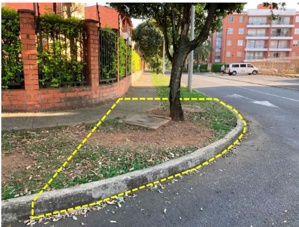
Figura 12. Cruce de la calle 15 con carrera 68: se evidencia la falta de elementos de accesibilidad universal (punteado color amarillo)
