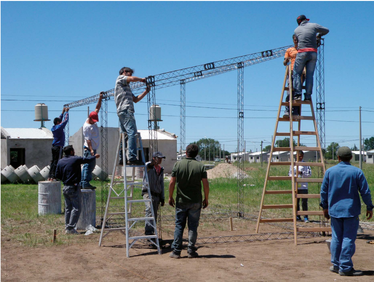
Figura 5. Cooperativistas junto a participantes del CEVE y representantes del IMV realizando el ensamblado de la estructura metálica del prototipo en la ciudad de Río Cuarto
